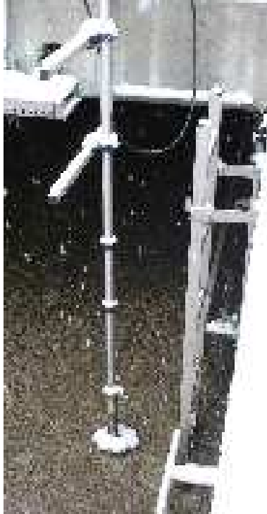
Abbildung 80: Einbau einer UV-VIS-Messboje im Belebungsbecken
