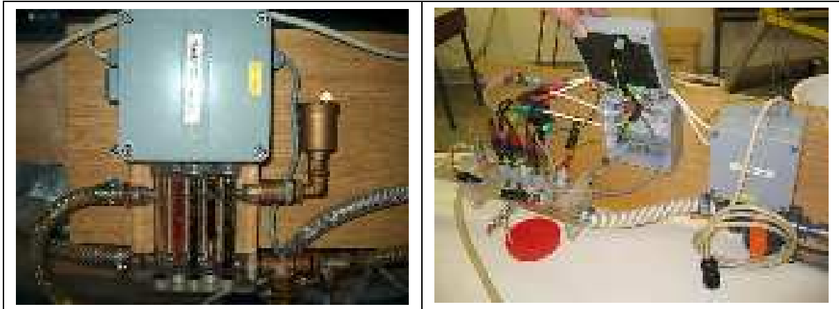
Abbildung 61: Durchflussarmatur der ISE-Sonden im Bypass; links : verstopfungsfällige und für Rohabwasser ungeeignete Durchflussarmatur, rechts : Prototyp einer für Rohabwasser geeigneten Durchflusszelle
