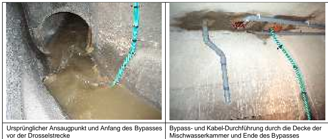
Abbildung 32: Bypass- und Kabeldurchführung in die Mischwasserkammer
