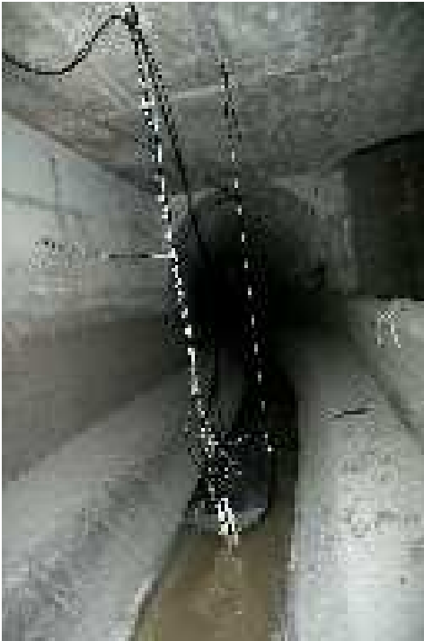
Der installierte Ponton und seine Aufhängung in der Mischwasserkammer
