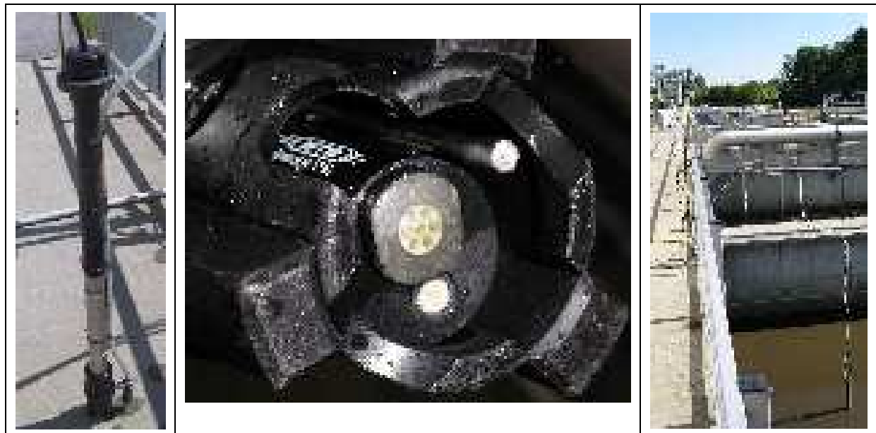
Abbildung 2: ISE-Einkanalsonde. Mitte : Sensorkopf, Rechts : Installation im Belebungsbecken
