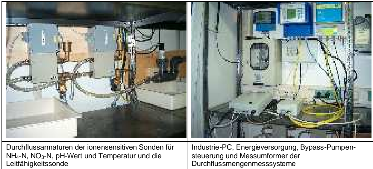
Abbildung 31: Installation der Sonden im Messcontainer
