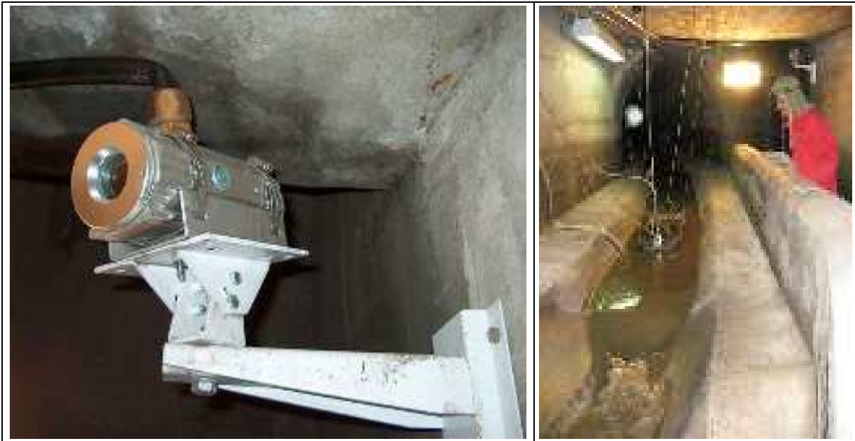
Abbildung 39: Videokamera und Beleuchtung zur Kontrolle und Aufzeichnung von Mischwasserereignissen
