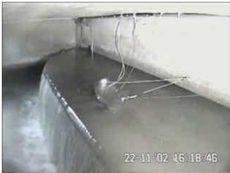
Abbildung 35: Ponton bei Mischwasserabfluss
