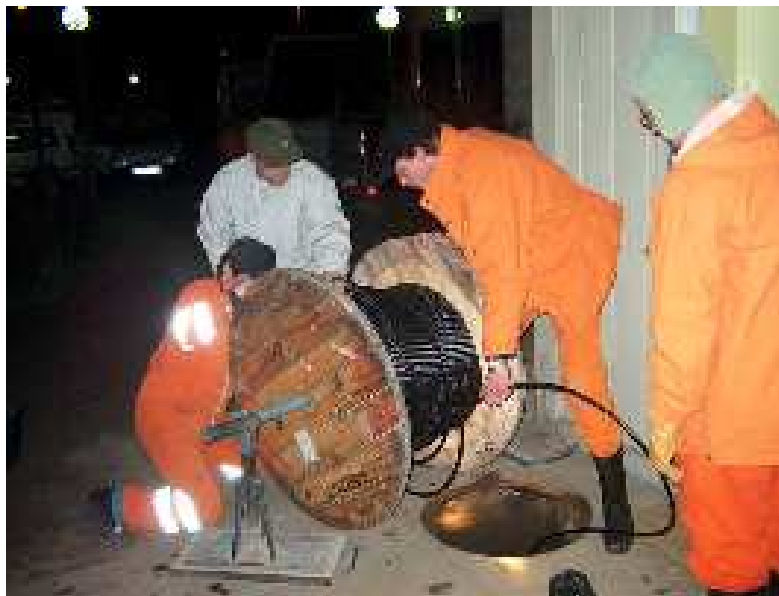
Abbildung 58: Einbau des Glasfaserkabels zur direkten Anbindung der Messstation Graz an das Internet
